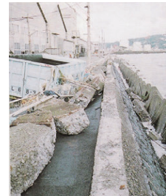
1993 台風による高潮被害
