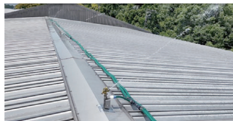
スプリンクラー4基設置 (1 分間散水、3 分間休止)
