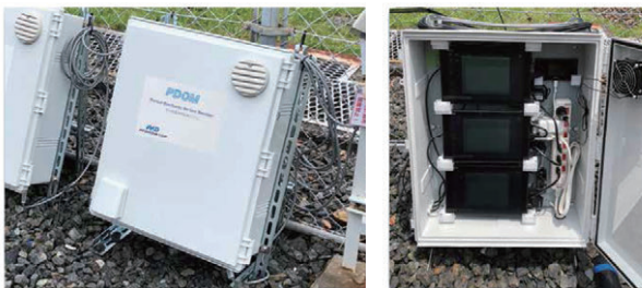
PDOM 実物 (屋外設置)
