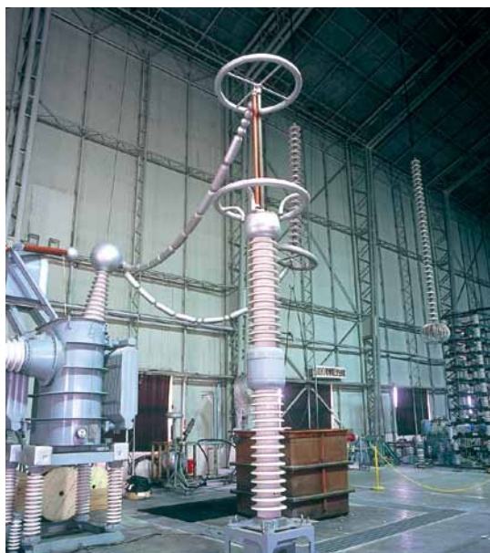
超高圧試験室
