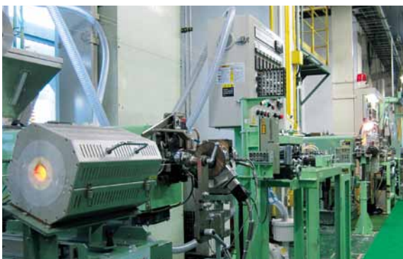
光ファイバケーブル製造ライン
