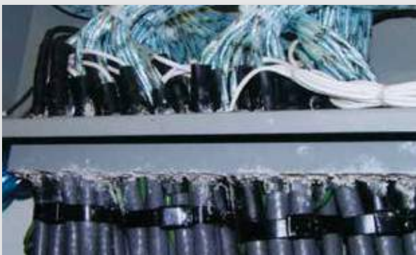
制御盤ケーブル結束 (NOR・NON)
