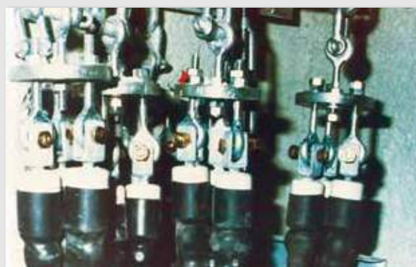
建筑物用电缆悬挂部 (NPE)
